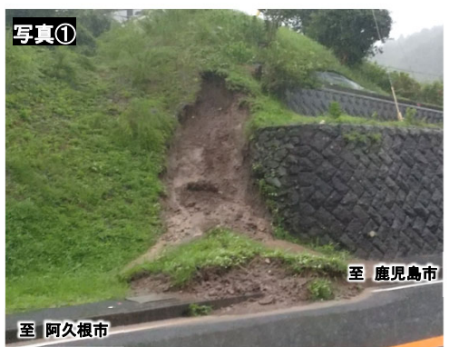
▲ 法面崩壊状況 (R3.7)
