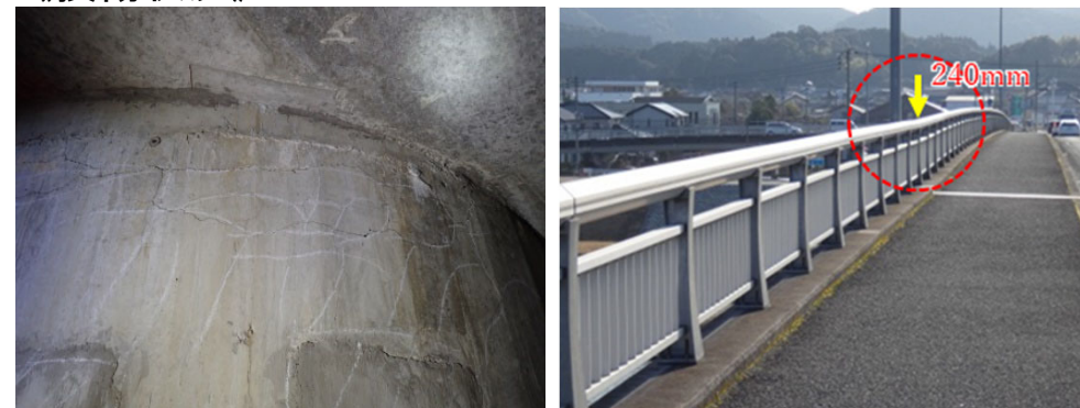
▲橋脚のひび割れ
