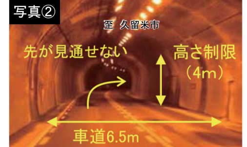
▲高さ制限と視距不足の状況
