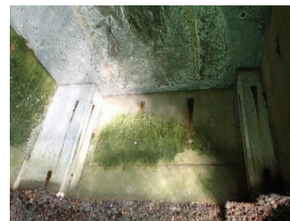
上部工の損傷状況
