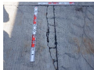
エプロンのひび割れ状況
