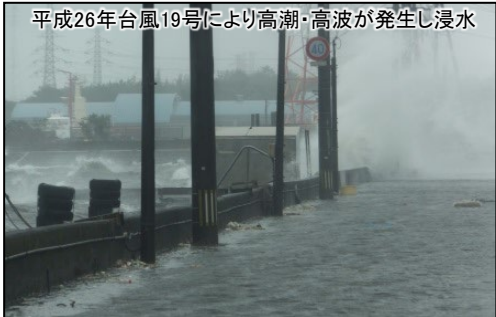
平成26年台風19号により高潮・高波が発生し浸水
