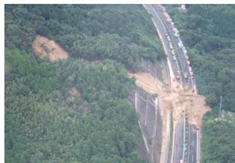
【大規模な法面崩落（九州縦貫自動車道）】
