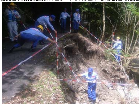
【緊急災害対策派遣隊(TEC-FORCE)による被害状況調査】
