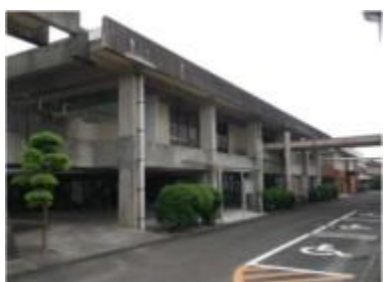
既存施設の老朽化の状況
