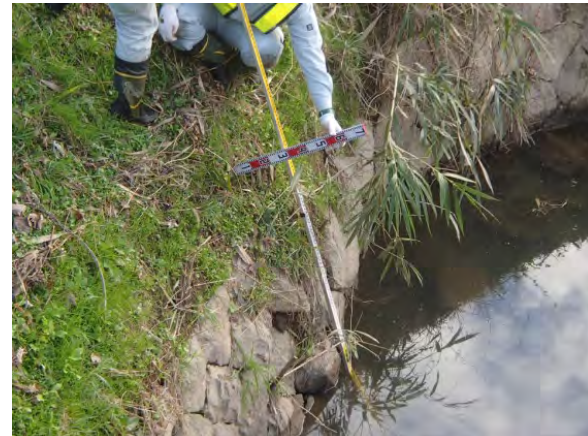
老朽化した低水護岸
