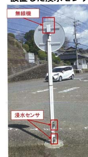
設置した浸水センサ
