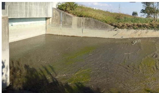
写真 2.1.14 水門前面水路のガタ土堆積状況
