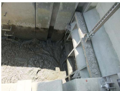
写真 2.1.12 樋門・樋管前面水路のガタ土堆積状況
