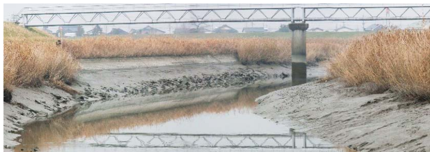
写真 2.1.2 河道に堆積するガタ土
