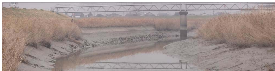
写真 5.2.7 河道に堆積するガタ土
