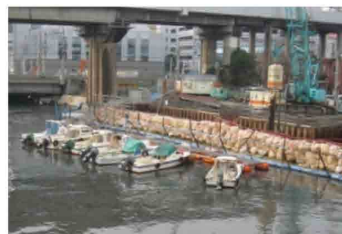
不法係留により河川改修工事に支障があった。 紫川水系紫川
