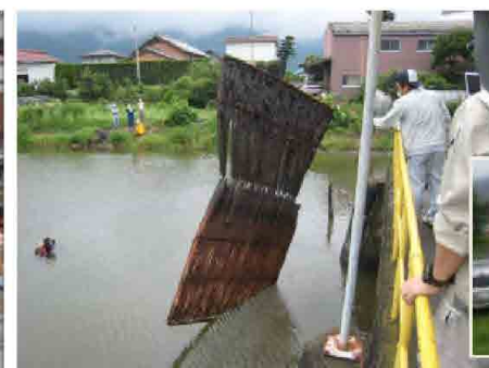
不法係留船が流出し、ポンプ施設を破損したため排水が不能になった。 木曾川水系山除川
