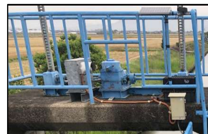
電動化設置例
