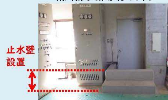
納所排水機場（多久市）
