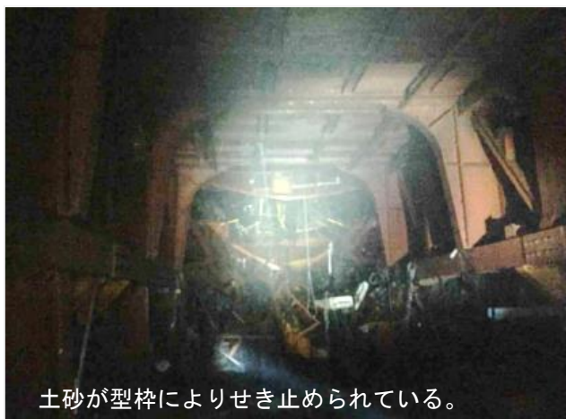
写真-1 仮排水路トンネルの土砂堆積状況
