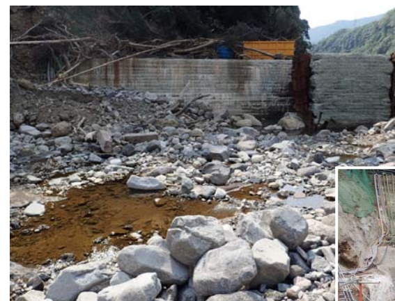
仮排水路トンネルの土砂埋塞 (H28.7)
