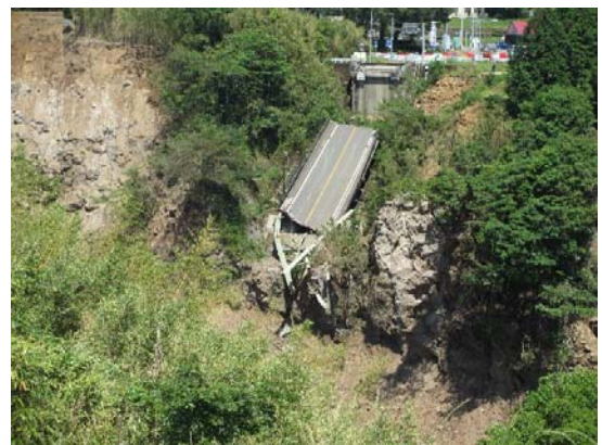
図-2 落橋した阿蘇大橋
