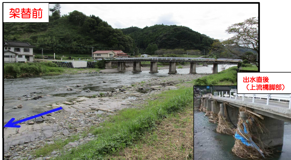
出水時の状況
