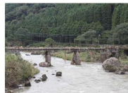
【増水により崩壊した橋梁（津美地区・鶴木）】
