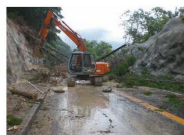
【土砂に埋もれた国道212号（中津下地区）】
