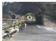
【ガートレーが壊れた耶馬溪の門（本耶馬溪地区）】
