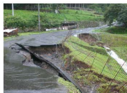
【道路の陥没した市道横野木線（倉田地区）】
