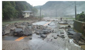
流れてきた巨石と砂に埋もれた国道212号（宮原地区）
