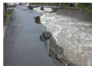
【田舎川の氾濫により崩壊された堤防（肥前豊地区）】
