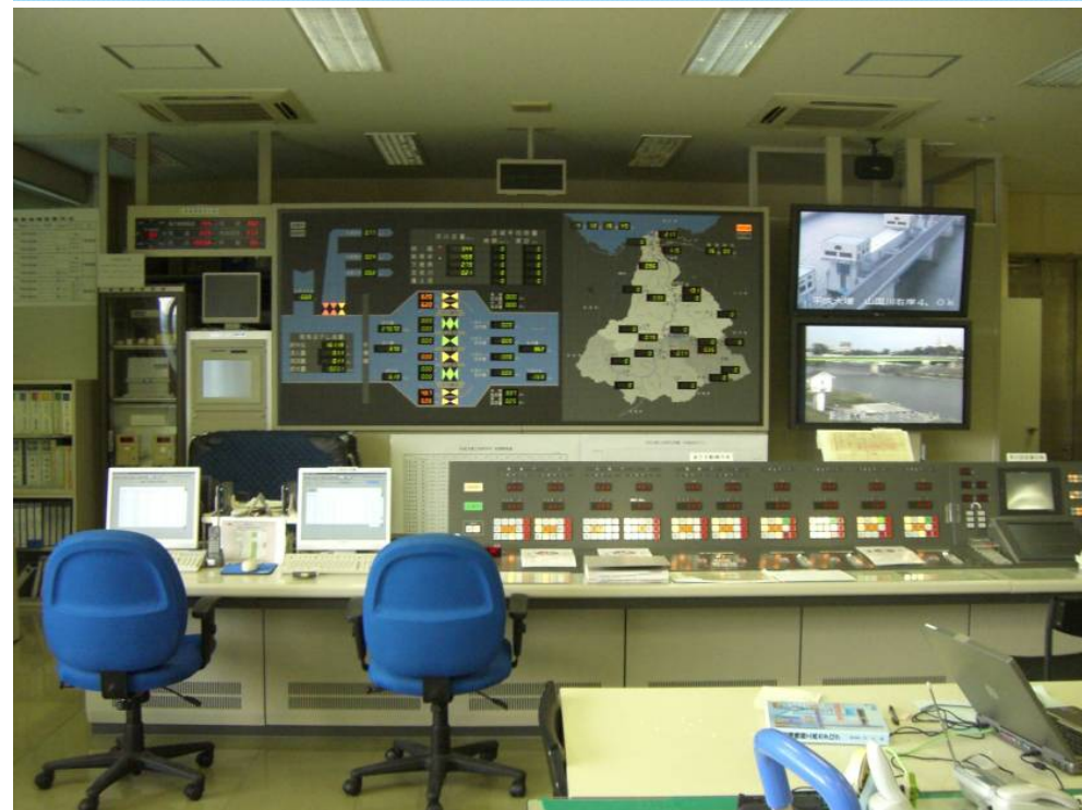
山国川河川事務所内操作室
