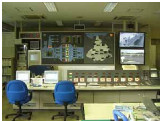
写真 4.3.3 山国川河川事務所内操作室
