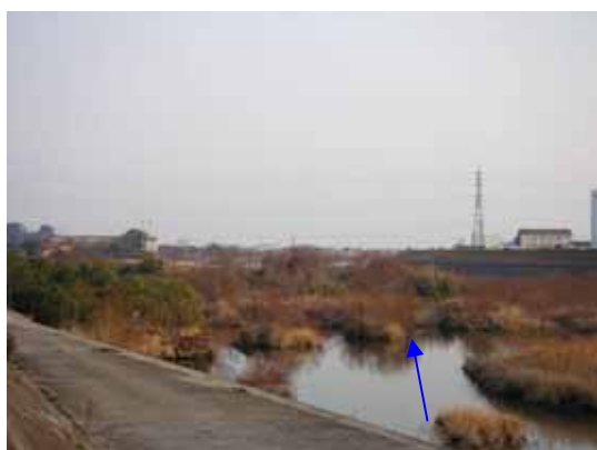
土砂堆積及び樹木繁茂
