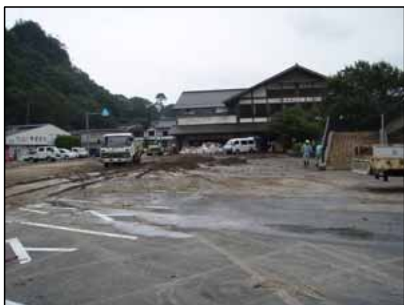
写真 1.2.4 青地区出水後の状況 (平成 19 年 8 月)
