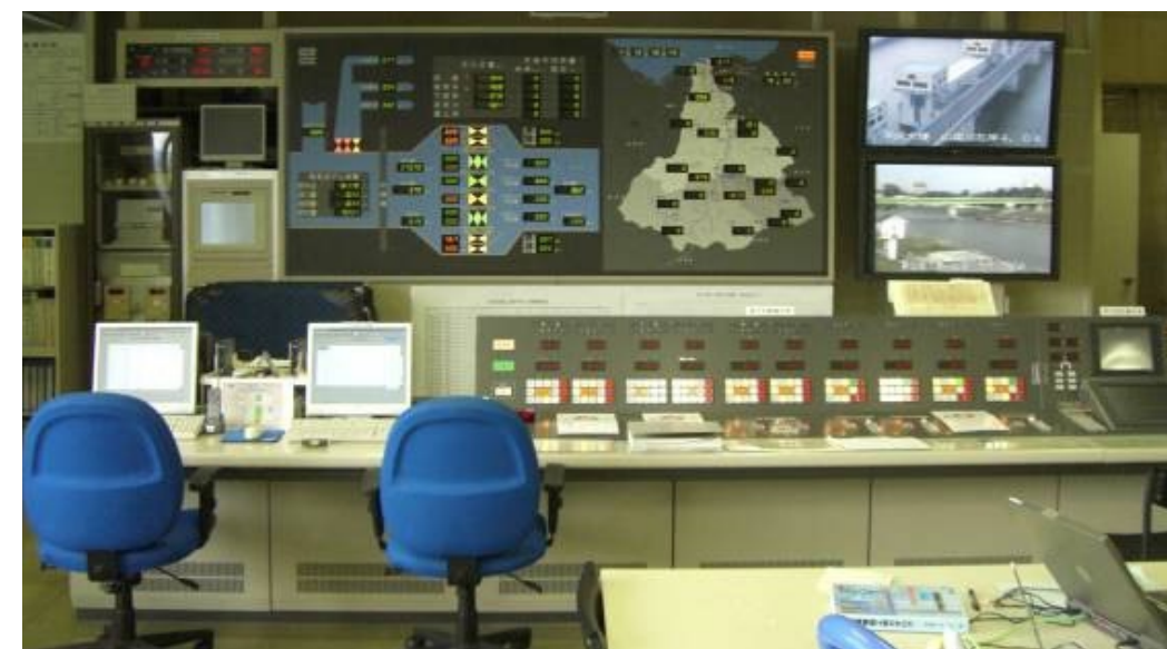
山国川河川事務所内操作室
