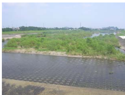
写真 2.1.3 土砂堆積及び樹木繁茂状況
