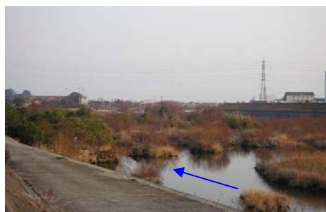
土砂堆積及び樹木繁茂
