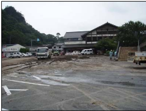
写真 1.2.4 曾木地区出水後の状況 (平成 19 年 8 月)
