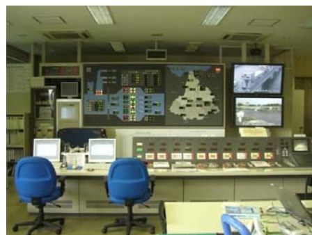
写真 4.3.3 山国川河川事務所内操作室
