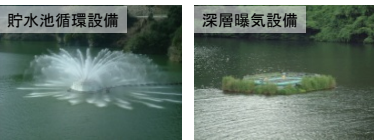
耶馬溪ダム水質保全装置
