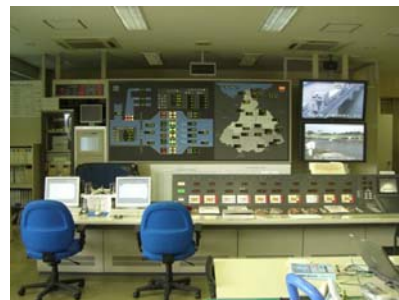
写真4.3.3 山国川河川事務所内操作室
