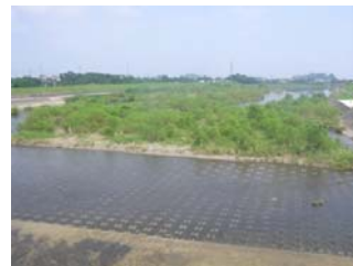
写真2.1.3 土砂堆積及び樹木繁茂状況
