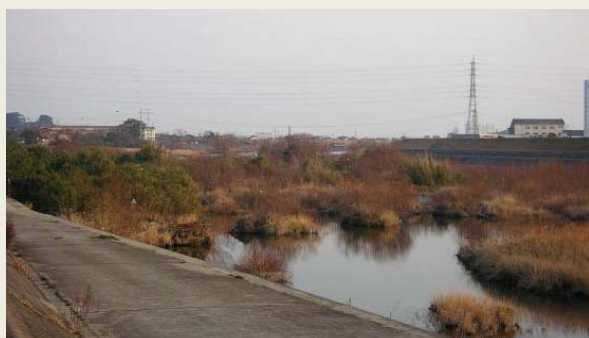
土砂堆積及び樹木繁茂
