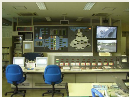
山国川河川事務所内操作室
