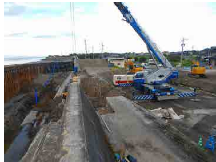
角木雨水ポンプ場 整備状況
