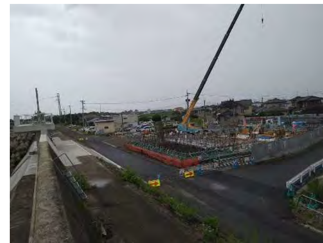
角木雨水ポンプ場 整備状況
