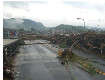
流木が橋にかかり水位を押し上げた事例
