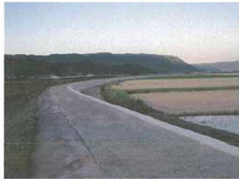
小倉遊水地(普段は水田として利用)を囲む堤防(工事中) 2015.6.6撮影
