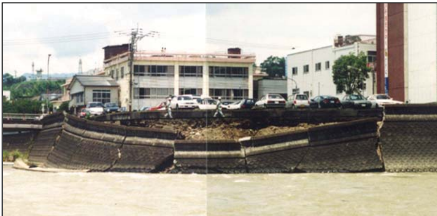
基礎洗掘により護岸が崩壊した球磨川の事例(山田川合流点) (H8年7月洪水)
