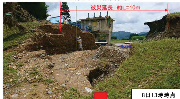
左岸55k000被災状況
