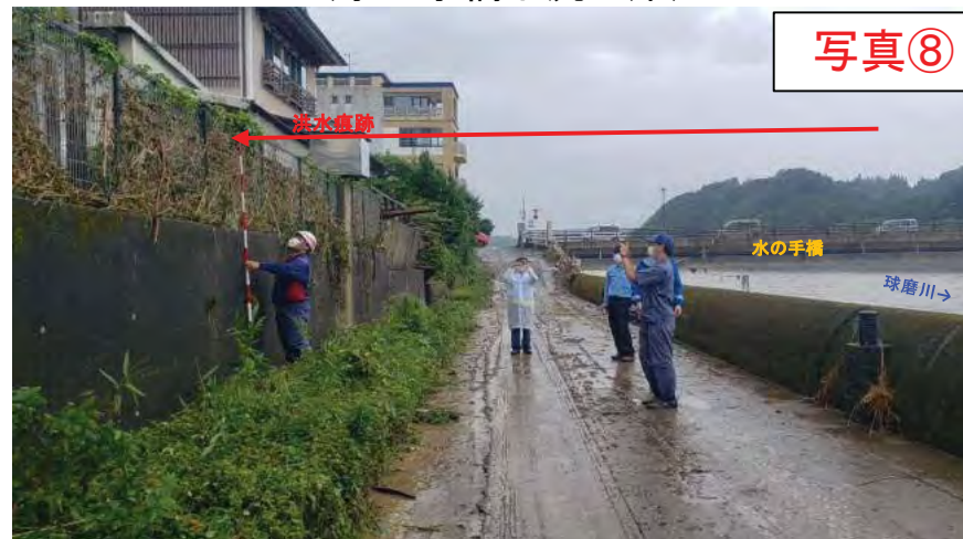
堤防を2m程度上回る高さに洪水痕跡を確認 (水の手橋下流右岸)
