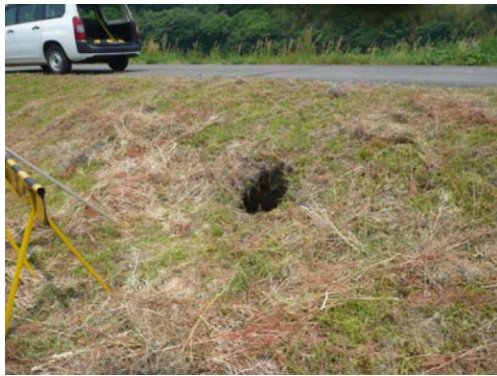
図 2.18 堤防陥没の発見箇所
