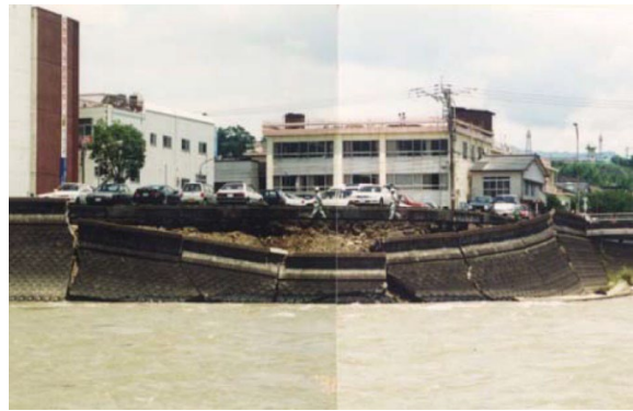
図 2.19 基礎洗掘により崩壊した護岸
