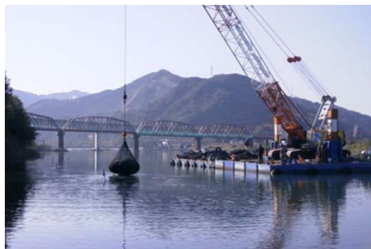
図 1.56 萩原地区の深掘れ対策状況（八代市）
