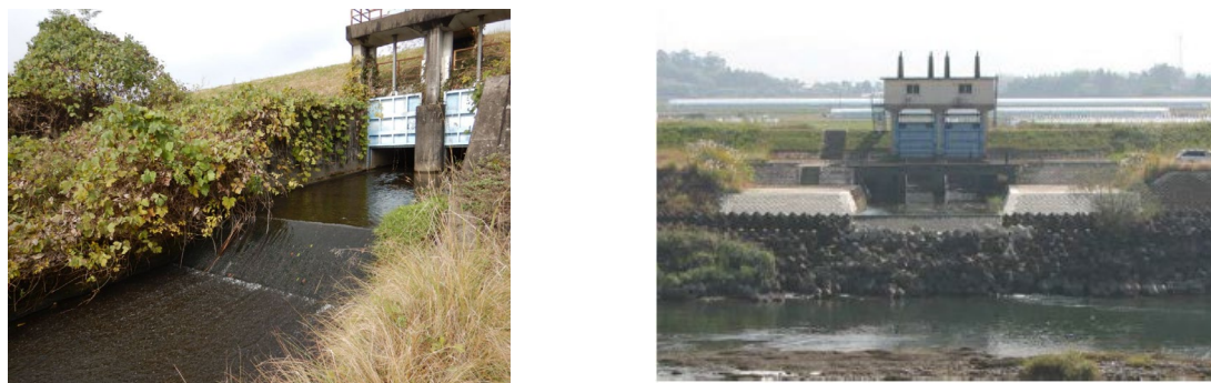
図 5.18 樋門流入口の段差状況
