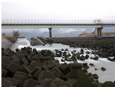
図 5.15 新前川堰の魚道
