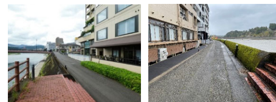
舗装の老朽化
