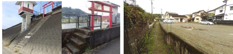
急勾配の階段(左)と施錠された階段(右) 整備されていない道
