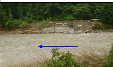
写真③ 川辺川・護岸一部欠損
