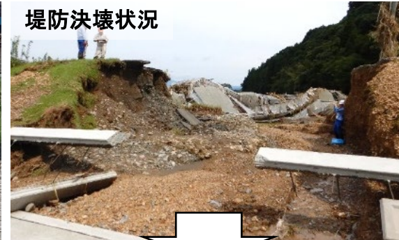
㉘堤防決壊箇所(球磨川左岸55.0k付近)
