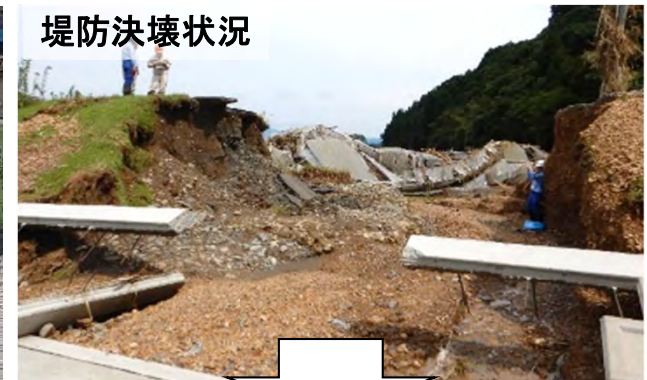
②堤防決壊箇所(球磨川左岸55.0k付近)
