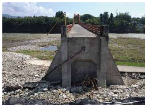
天狗橋左岸側の配水管の流失
