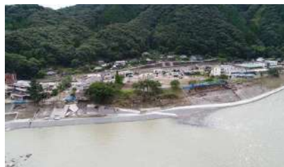
② 護岸被災 (八代市坂本町坂本地先)
