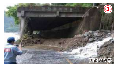
土砂流入により国道219号が被災(球磨村渡地区)
