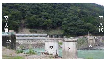
被災後の状況(上部工 A1～A2間 流失)
