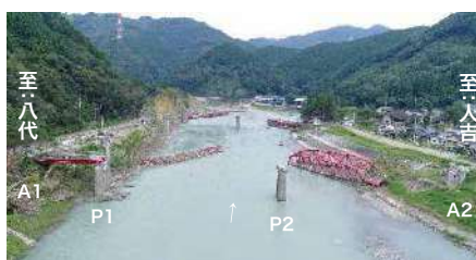
被災後の状況(上部工 A1～A2間 流失)
