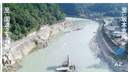
被災後の状況(上部工 A1～A2間 流失)
