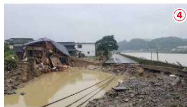
堤防の損傷と氾濫流による家屋倒壊が発生(人吉市下薩摩瀬町)
