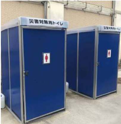
マンホールトイレ(人吉市)
