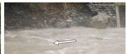
④梶原川・護岸一部欠損
