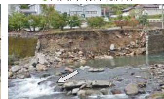
⑥ 胸川・護岸一部欠損
