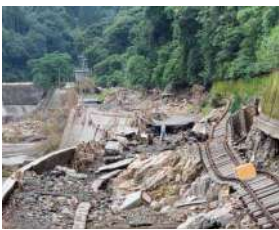
⑤軌道損壊
