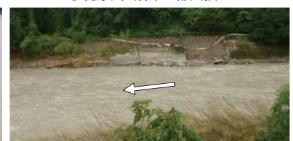
⑤川辺川・護岸一部欠損
