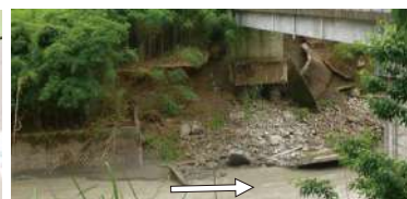
①川辺川・護岸一部欠損
