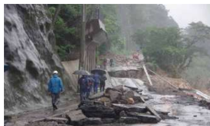
国道219号(7月10日:大瀬橋付近)
