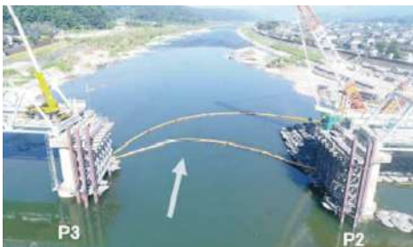
被災状況(令和2年8月18日時点)
