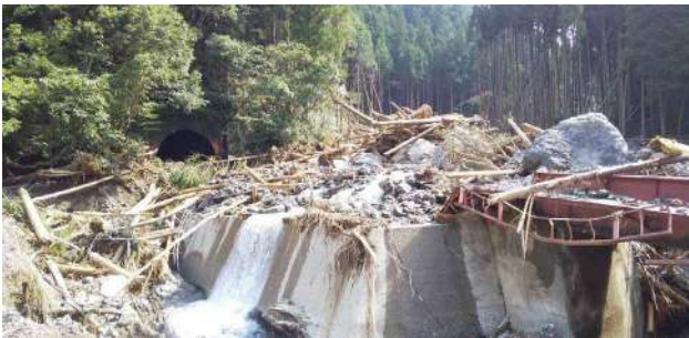
土石流等の被害 (JR肥薩線 行徳川橋梁)
