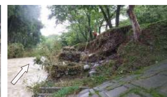
④ 馬水川・護岸一部欠損
