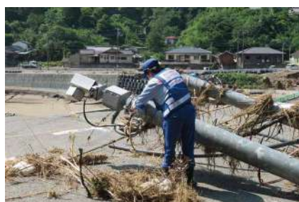
被災状況調査 (八代市坂本町 鎌瀬橋カメラ)
