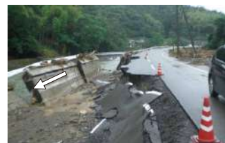
③吉尾川・護岸一部欠損
