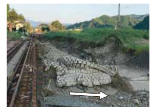
⑥小川・堤防一部欠損
