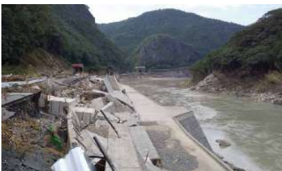
④ 護岸被災 (球磨村一勝地地先)
